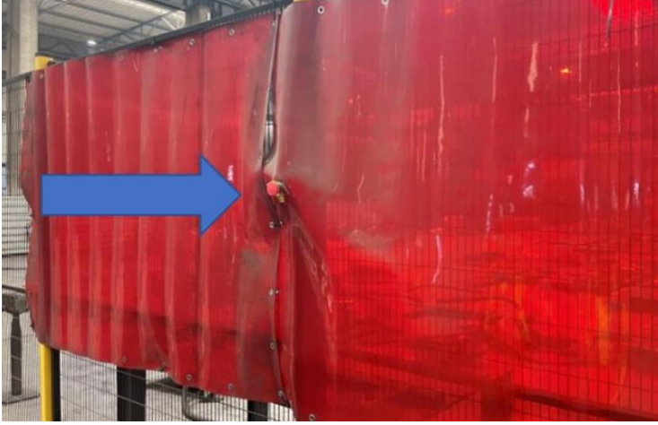
ŞEKİL 60: Yanlış Acil Durdurma Butonu Uygulaması
